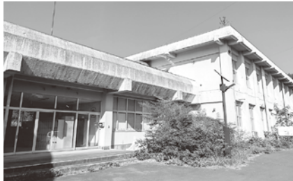
アスベストがある場合は、ばく露・飛散防止対策が必要となる
